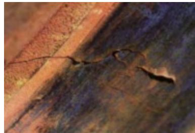
(b) Fatigue crack
